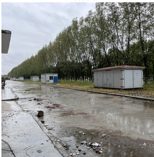
项目东侧配电房
