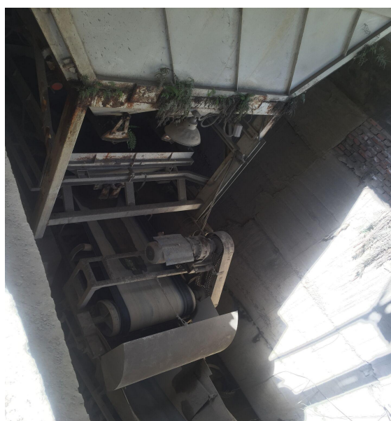
整改前：配料斗卸料处无喷雾装置
