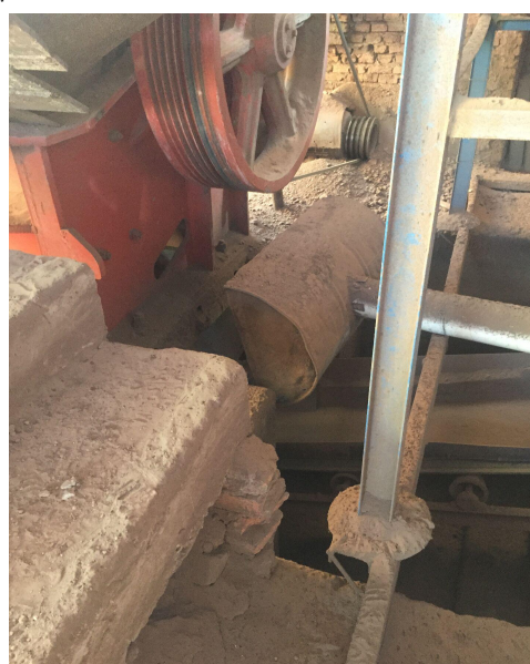
整改后：鄂破机出料口集尘罩
