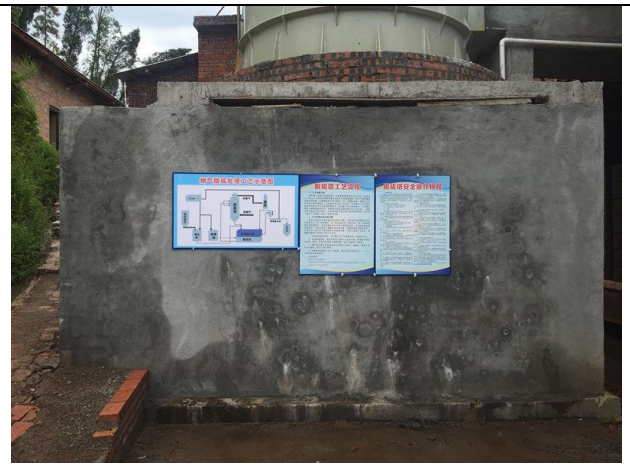
脱硫塔处理工艺及安全操作规程上墙
