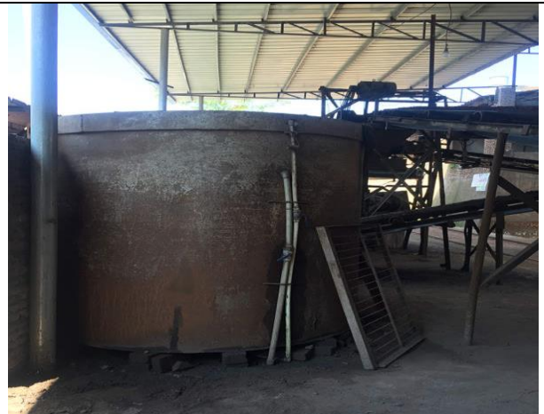
真空挤砖机冷凝水罐
