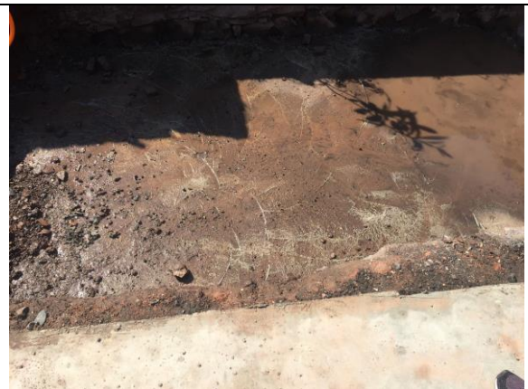
车辆冲洗平台沉淀池
