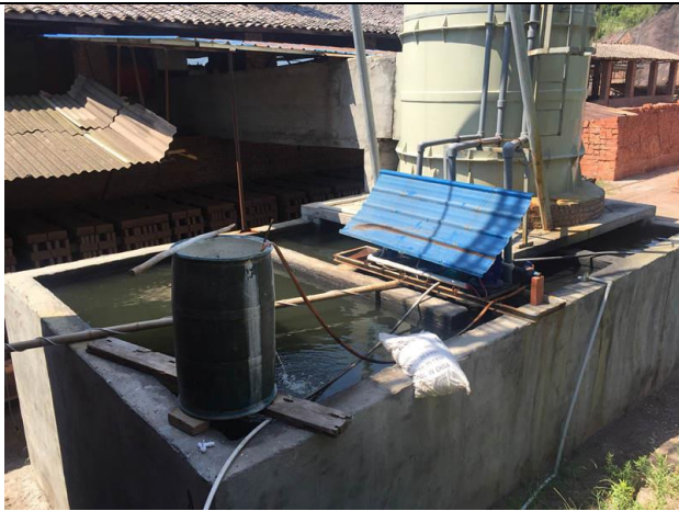
脱硫塔循环水池
