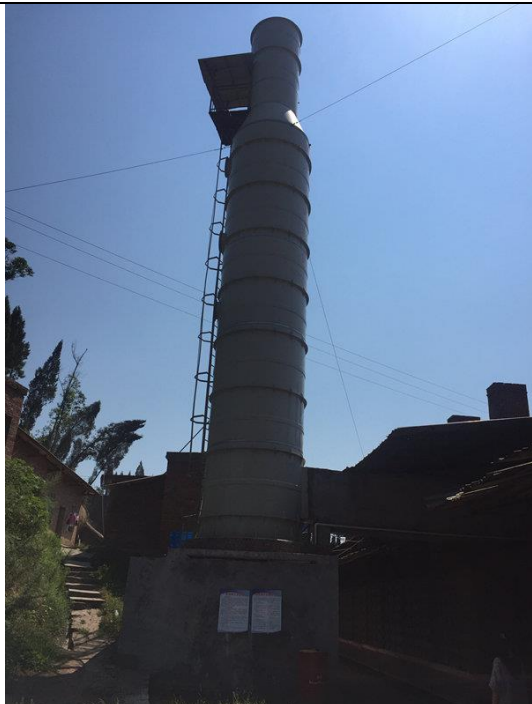
双碱法除尘脱硫塔+20米高排气筒
