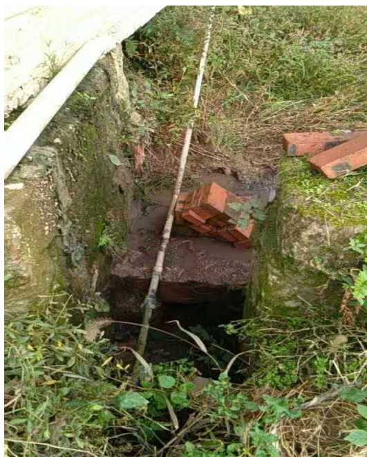
整改前：池子排口无溢流挡墙
