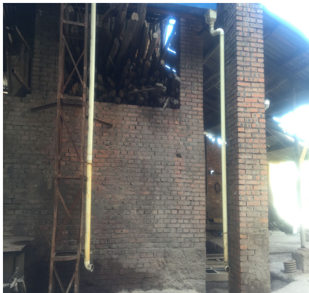
整改前:雨棚排水管悬空
