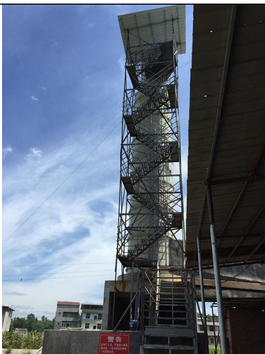
双碱法除尘脱硫塔+20米高排气筒
