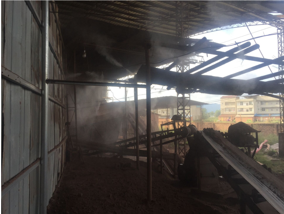
高压喷雾设施
