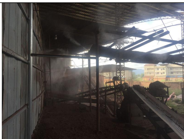
鄂破高压喷雾设施
