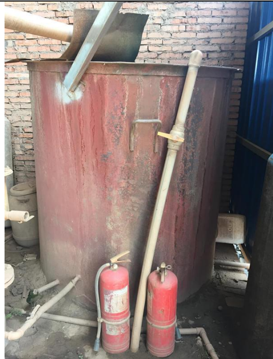
真空挤砖机冷凝水罐
