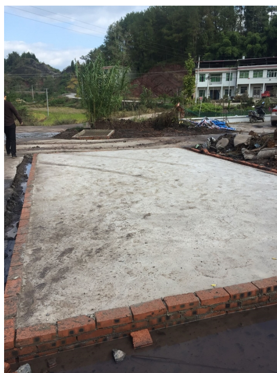
整改后：车辆冲洗平台+沉淀池
