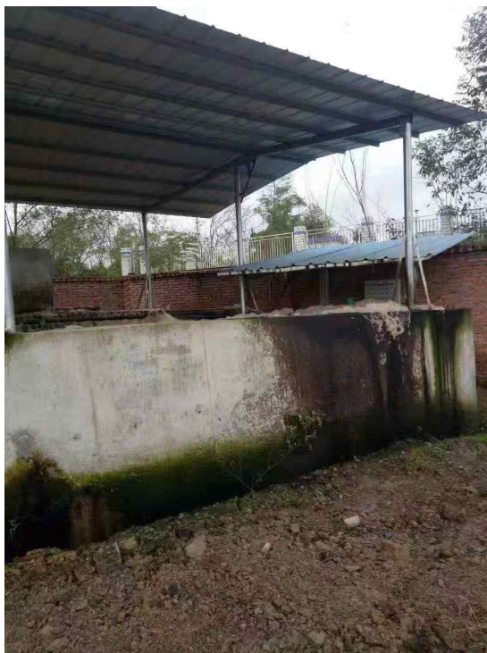
整改前: 污水处理站泡沫外溢
