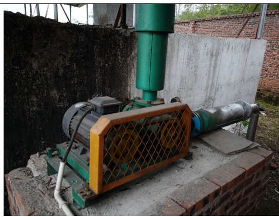
水泵基座减振
