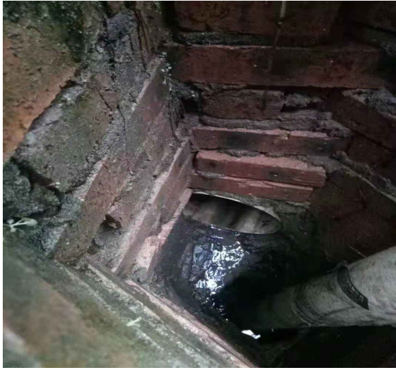
整改前：污水处理站废水排口涵管未封堵
