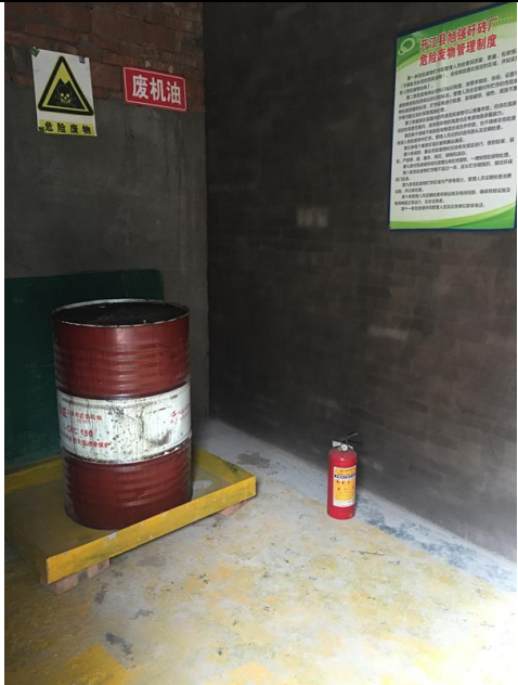
危险废物暂存间内部
